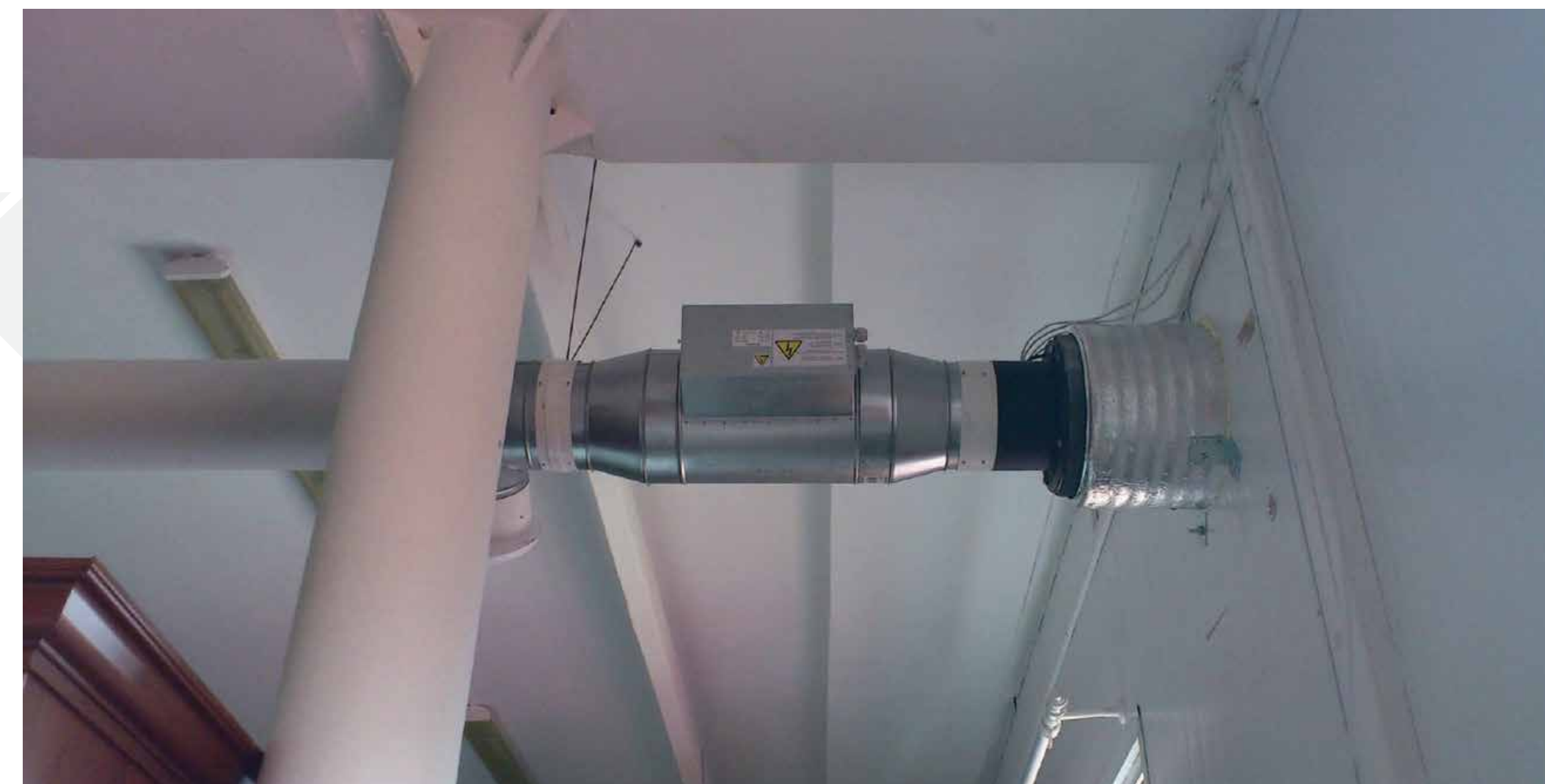
Rekuperator PRANA-250, montaža na zid + korišćenje električnog kalorifera
