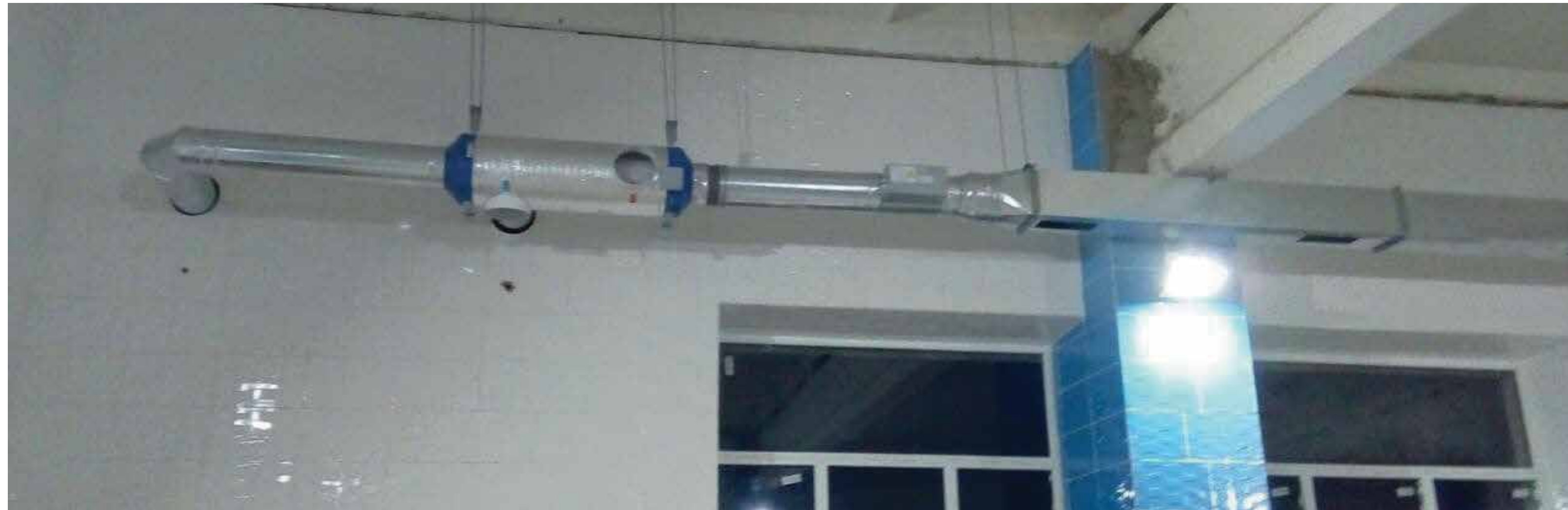
Rekuperator PRANA-340S, unutrašnja montaža, ventilacija bazena.
